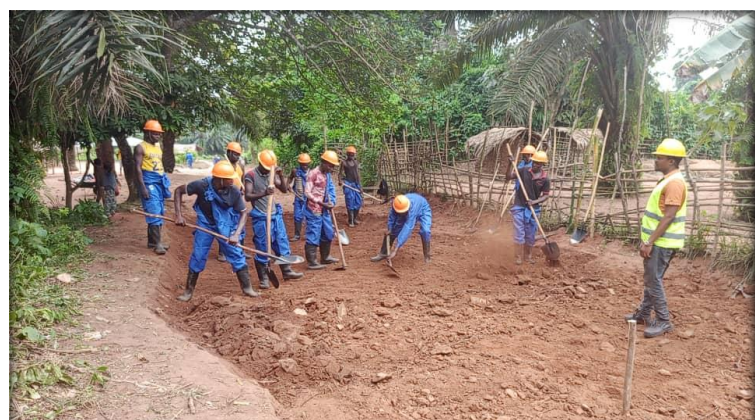
Entretien des routes de dessertes agricoles par la méthode HIMO à Bodeme II
